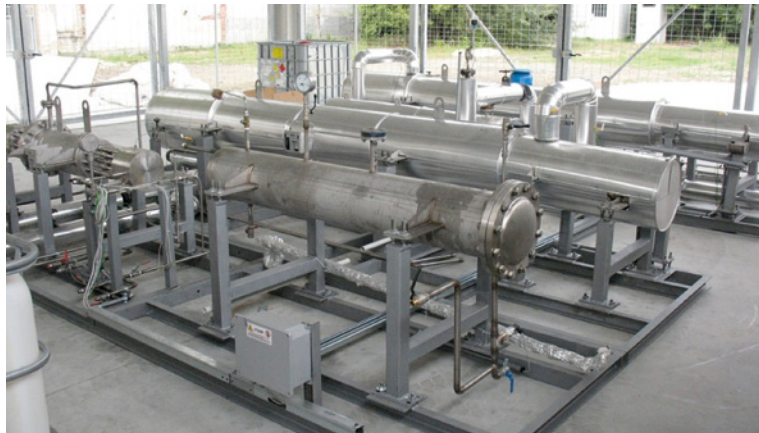
Abbildung 14: Aufbau der Pilotanlage des im Rahmen des Verbundprojektes CoPIRIDE neu entwickelten superkritischen Biodiesel-Verfahrens an einem Standort in Alessandria, Italien 77
